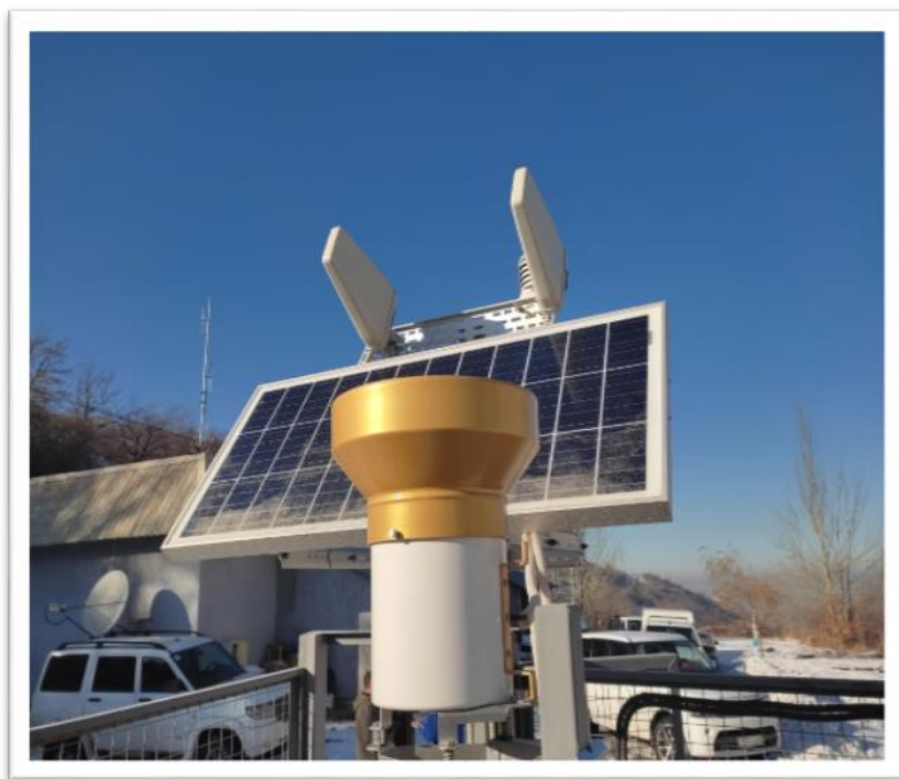
Станция АСМ по бассейну реки Аксай в г. Алматы
