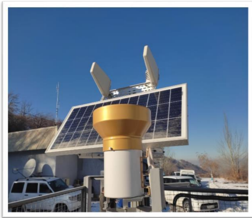
Станция ACM по бассейну реки Аксай в г. Алматы
